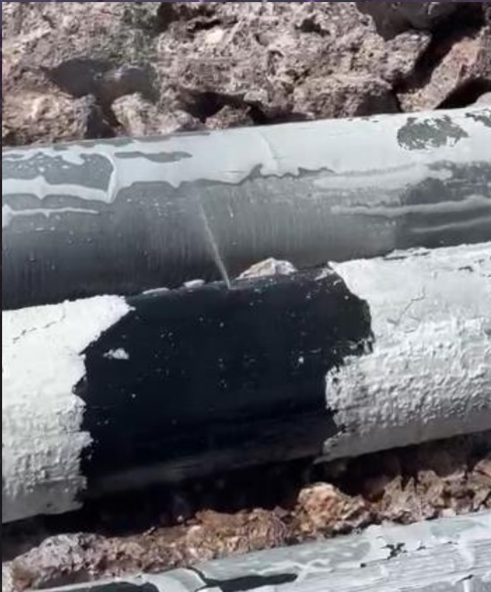
Figura 2: Fuga puntual en tubería
