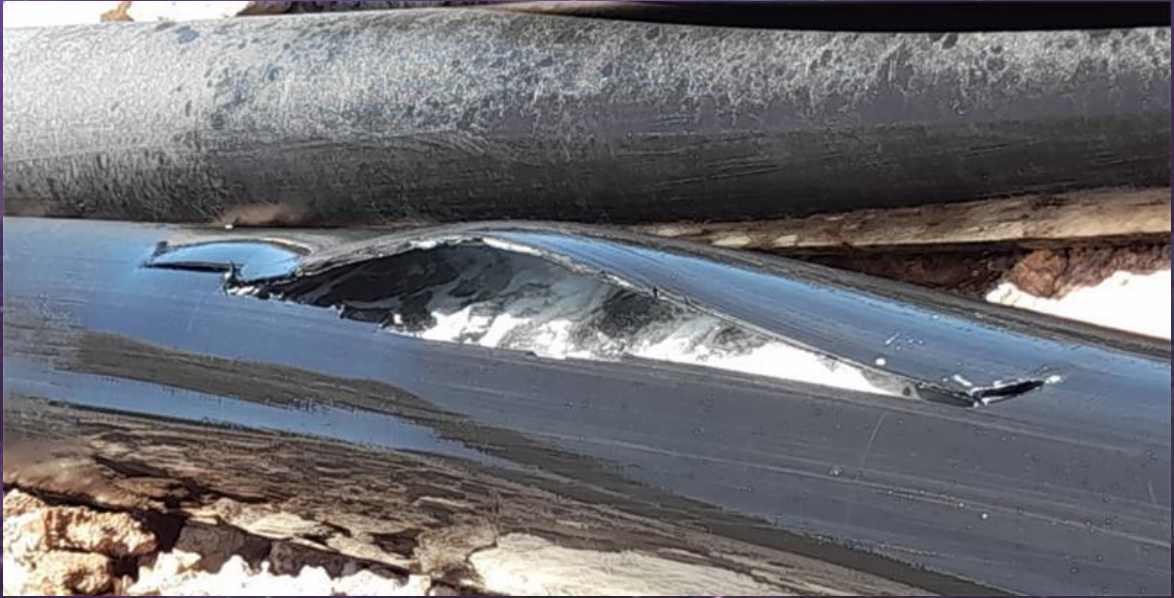
Figura 1: Ruptura lineal de tubería de 500 mm de extensión
