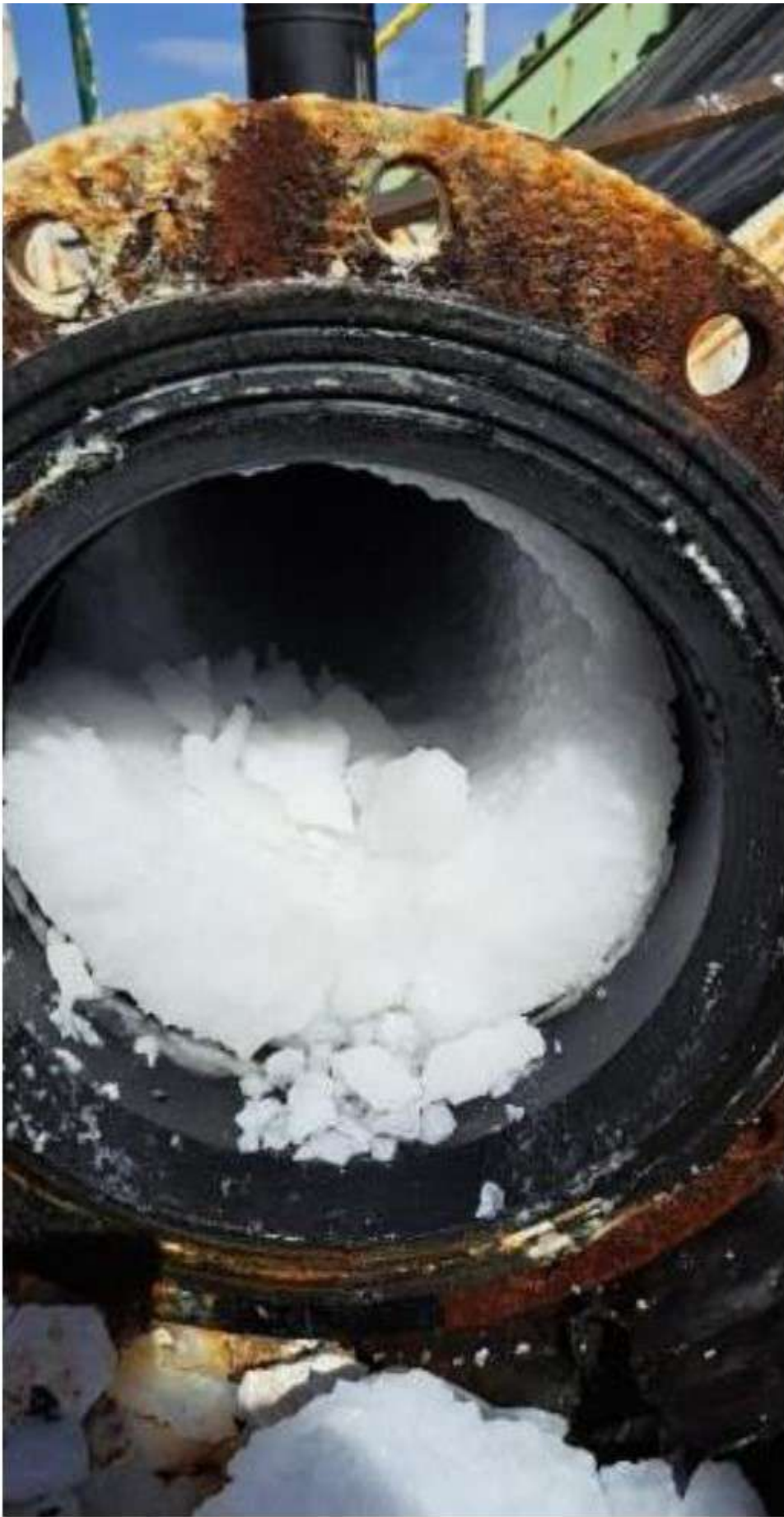
Incrustación en componentes (tuberías HDPE de bomba antes de llegar a flujómetro – Sector frecuente de incrustación)
