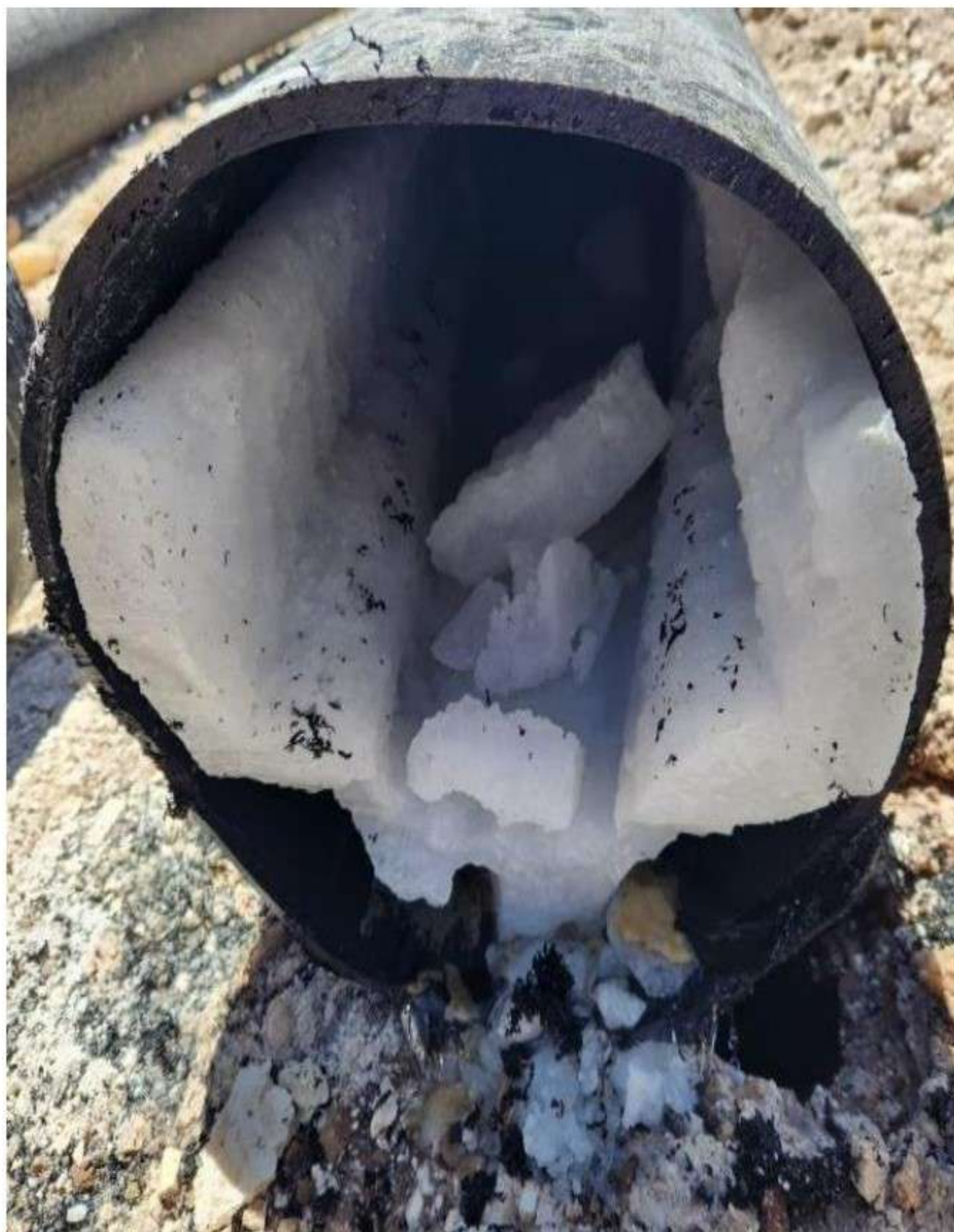
Incrustación interior tubería de HDPE
